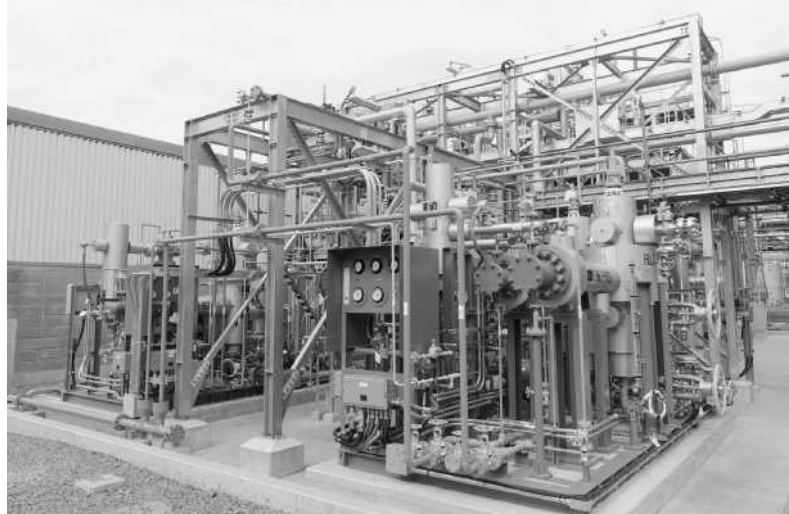
住友化学のCO2から高効率にメタノールを製造するパイロット設備
