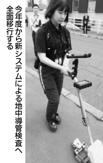
今年度から新システムによる地中導管検査へ全面移行する
